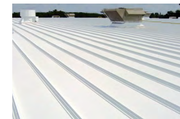
REJEIÇÃO DE CALOR
